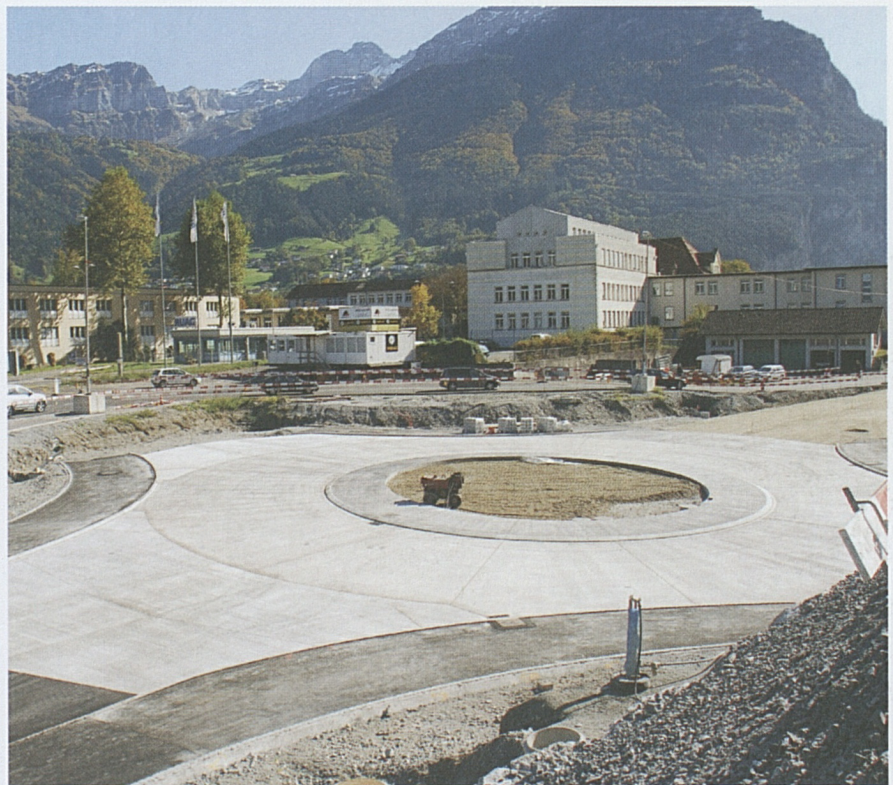
Verkehrsknotenpunkt Wysshus: Die Arbeiten am neuen Kreisel auf der Ostseite kommen zügig voran.
