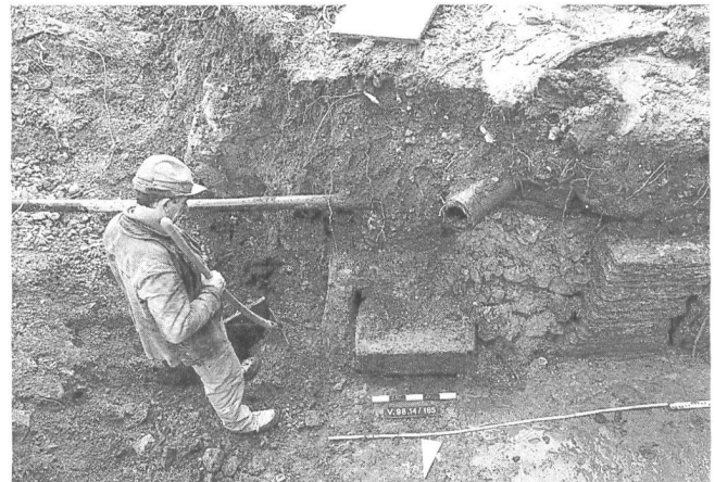
Abb. 2: Windisch-Klosteranlage Königsfelden 1999 (V.98.14): Stützpfeiler in der «Wasserkammer» des Wasserleitungssystems aus der Berner Zeit. Schrägaufsicht aus Norden (Leitungsgraben XV).
