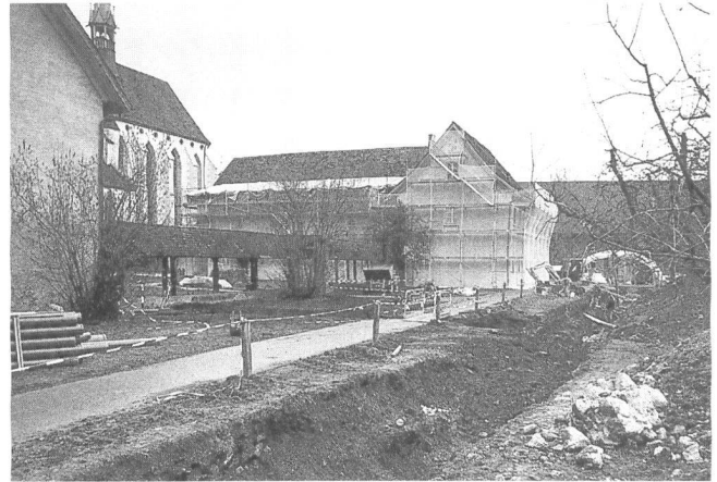
Abb. 1: Windisch-Klosteranlage Königsfelden 1999 (V.98.14): Die Situation des Leitungsgrabens II südlich des Kreuzganges des Klosters Königsfelden. Ansicht aus Südwesten.
