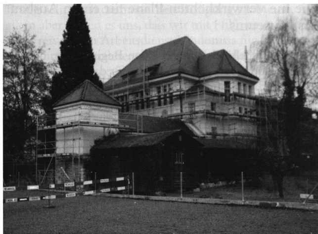
Abb. 1: Die Rückseite des Vindonissa-Museums mit Baugerüst. Die grossen Bäume sind inzwischen gefällt, die unschönen Baracken sollen demnächst entfernt werden (Foto D. Käch, Dezember 2007).
