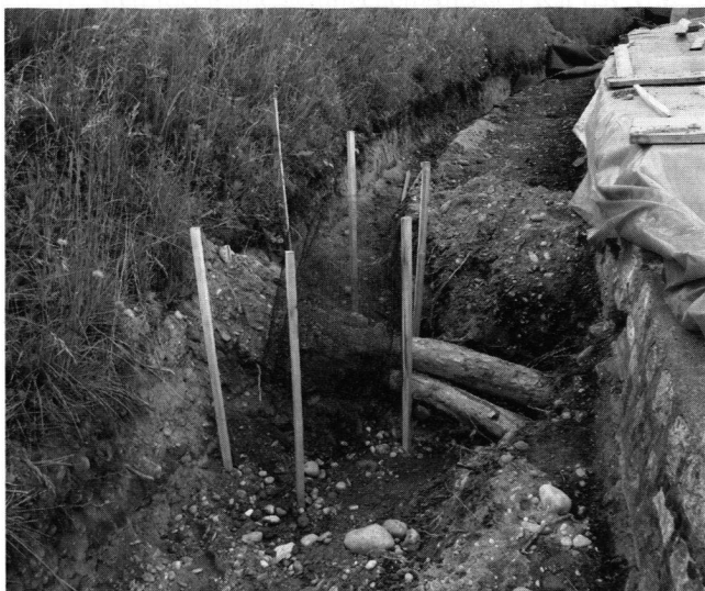
Abb. 2: Armdicke Pappelwurzeln haben das Mauerwerk unterwachsen und führen zu Zerstörungen (Foto T+U AG).
