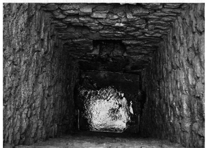
Abb. 17: Windisch-Im Winkel (V.010.5). Blick von oben in den geöffneten Schacht der römischen Wasserleitung.
