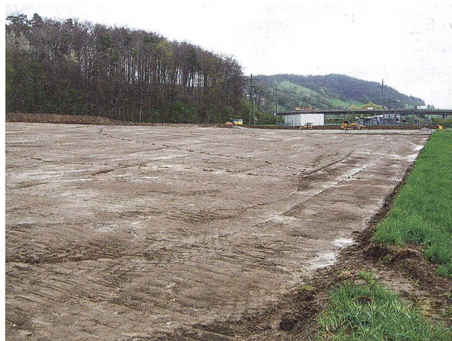
Abb. 14: Lupfig-Guggerhübel 2012 (Lup.012.1). Blick von Südwesten auf das abhumusierte Areal im Bereich der «toten» römischen Wasserleitung von Vindonissa . Das antike Bauwerk verläuft hier in der natürlichen Senke zwischen dem Guggerhübel (im Vordergrund) und dem Eitenberg (rechts im Hintergrund) – genauso, wie es heute SBB-Linie, Kantonsstrasse und Autobahnzubringer tun.
