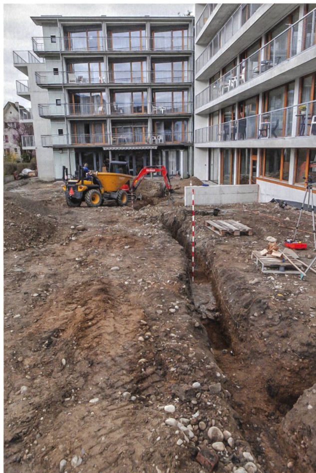
Abb. 25: Windisch-Lindhofstrasse 2013–2016 (V.013.3). Blick von Osten auf den laufenden Betrieb der Grossbaustelle. Im Graben einer Erdsondenleitung wurden die gemauerte Wasserleitung (Jalon im Vordergrund) und die Tonröhrenleitung (Jalon im Hintergrund) an den erwarteten Stellen angeschnitten.
