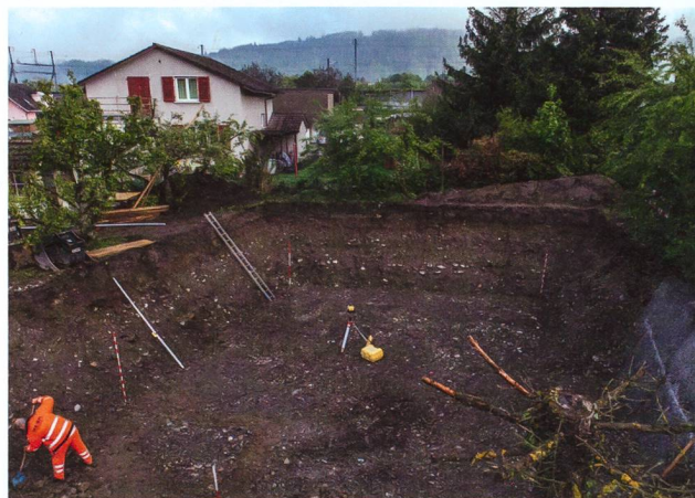
Abb. 25: Windisch-Bühlweg 2017 (V.017.3). Blick von Südosten auf die fertig ausgehobene Baugrube mit der geologischen Schichtabfolge im Bereich der Niederterrasse von Aare und Reuss. Im Hintergrund die SBB-Linie Brugg-Baden.
