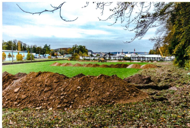
Abb. 31: Brugg-Hämike 2018 (Bru.018.6). Blick von Südwesten auf die Baggerschnitte im Wiesland. Links die SBB-Trasse und die begleitende Kantonsstrasse, welche in diesem Bereich möglicherweise auf eine römische Fernstrasse von Vindonissa nach Aventicum zurückgeht.
