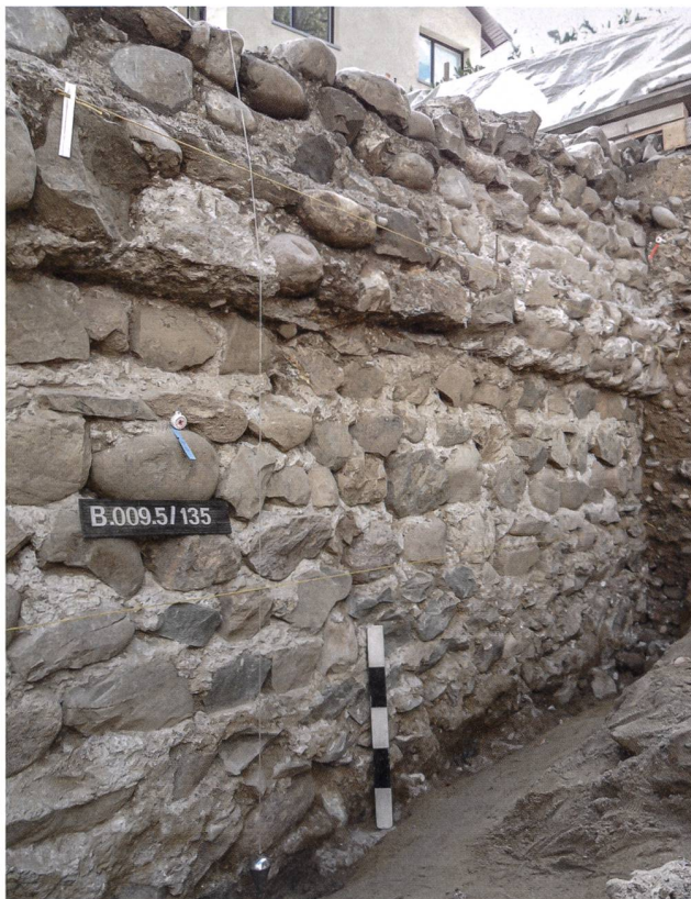
Abb. 16: Baden-Dependance Ochsens 2009–2010 (B.009.5). Ansicht der komplett freigelegten Mauer M1 mit Verbreiterung auf Höhe des Kieskoffers. Blickrichtung Süden.
