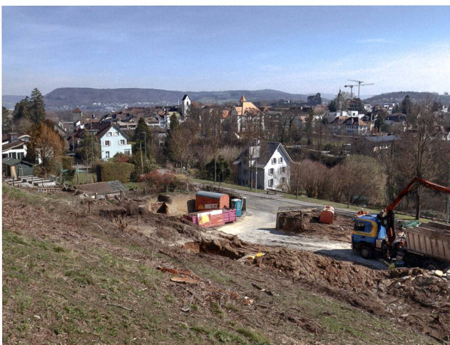
Abb. 29: Brugg-Baslerstrasse 2018–2019 (Bru.018.5). Blick von Nordwesten auf die laufenden Abbrucharbeiten in der Parzelle am Bruggerberg. Am linken oberen Bildrand das Areal des römischen Gräberfelds am «Remigersteig».
