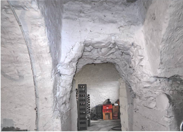
Abb. 6: Mumpf AG, Liegenschaft Hauptstrasse 93 (Gasthof zum Anker). Blick von Osten auf den Durchgang zwischen Keller 35 und Keller 37. Der Durchgang wurde 1949/50 aus dem beim Bau der Liegenschaft (1829) unterfangenen Fundament der Ostmauer des Mitteltrakts der spätantiken «Magazinstation» ausgeschrotet. Die UK des spätantiken opus caementitium entspricht der OK der 1998 erstellten Betonunterfangung (Zustand 2017).
