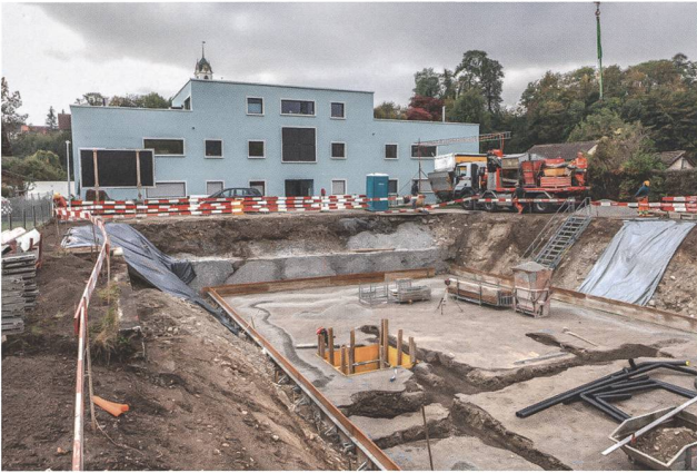
Abb. 27: Windisch-Nordtorweg 2020 (V.020.9). Blick von Norden in die fertig ausgehobene Baugrube mit den gesicherten Baugrubenwänden. Im Mittelgrund ein neues MFH, dessen Baubegleitung 2018 ebenfalls ohne archäologischen Befund blieb (V.018.4). Dahinter die Turmspitze der Windischer Dorfkirche oben auf dem Plateau mit dem Legionslager.
