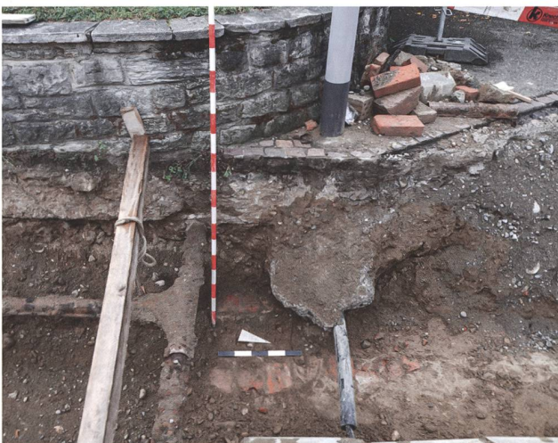
Abb. 11: Windisch-Klosterzelg 2017–2020 (V.017.2). Blick von Osten in einen Abschnitt des Werkleitungsgrabens in der Reutenenstrasse. Unter der modernen Wasser- und Kandelaberleitung sind auf der Grabensohle die vermörtelten Kalksteine vom Unterbau einer älteren Tonröhrenleitung angeschnitten.
