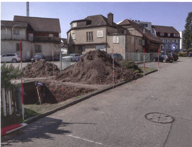
Abb. 8: Windisch-Scheuergasse 2021 (V.021.4). Blick von Nordosten auf den geöffneten Sondageschnitt in einer kleinen Wiesenfläche südlich der Scheuergasse.
