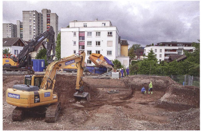
Abb. 27: Brugg-Wildenrainweg 2022 (Bru.022.3). Arbeitsfoto von Osten zur westlichen Baugrubenwand. Über dem anstehenden gelben Silt liegt eine neuzeitliche Humusschicht, gefolgt von einer bis zu 2 m starken modernen Aufschüttung.
