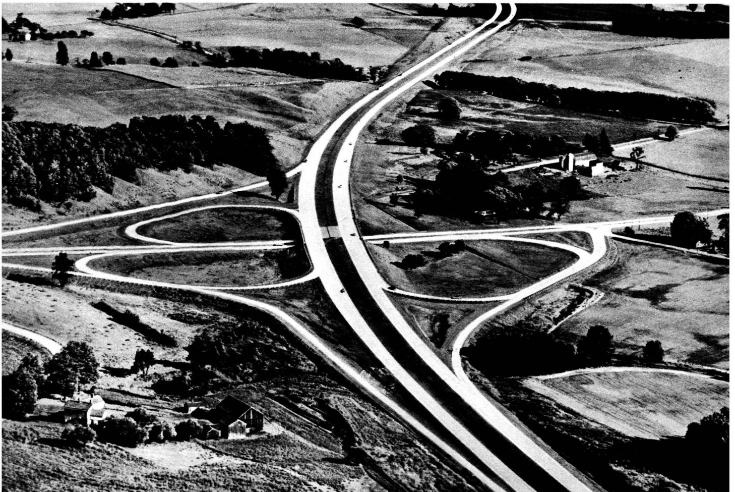
Un raccordement à l'autoroute en construction dans l'Etat new yorkais Thrummy qui sera longue de 902 km. (Photo Ford Motor Company, obligeamment prêtée par le Service de presse du Consulat des Etats-Unis, à Genève.)
