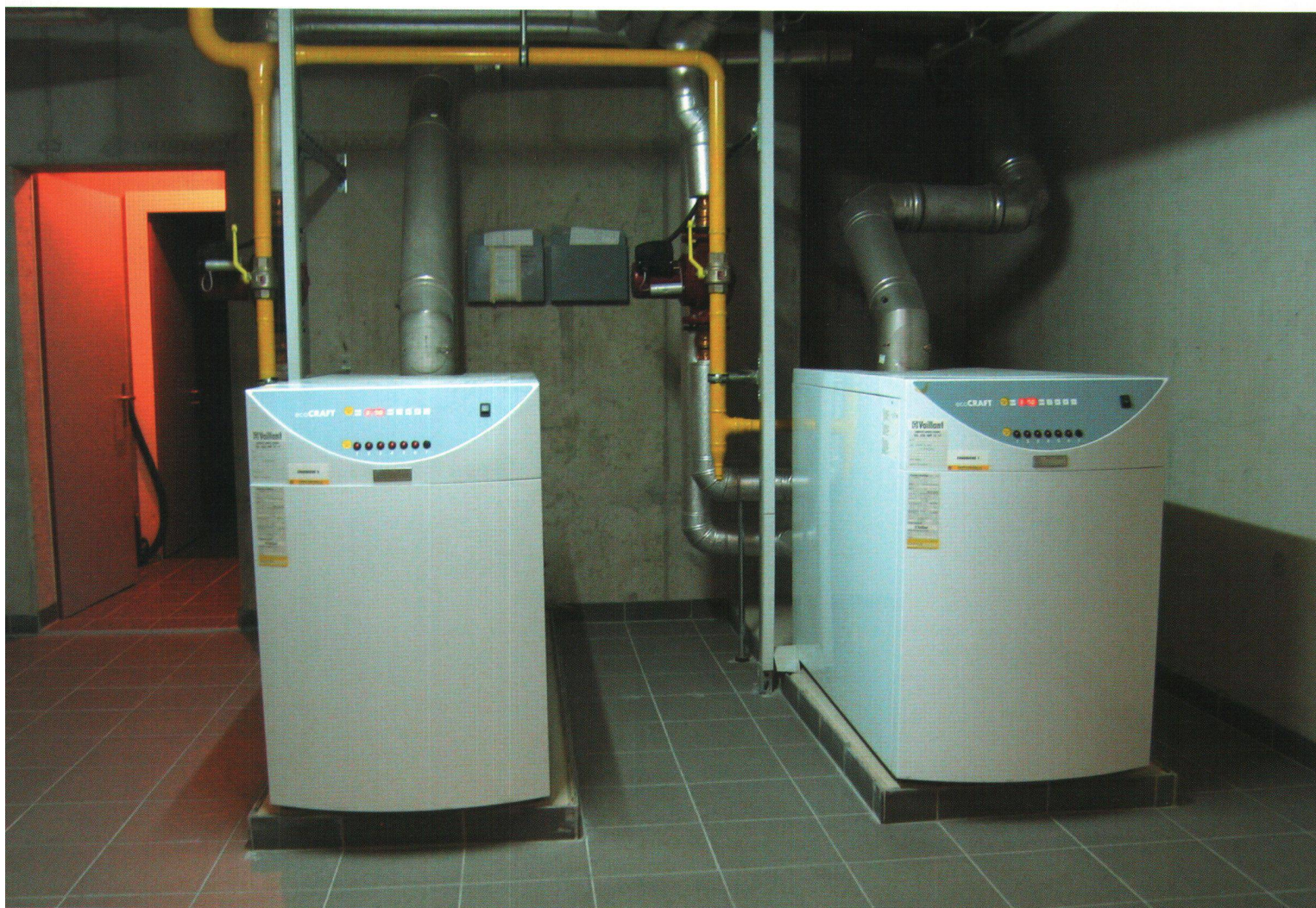
Production de chaleur à gaz pulsé.
