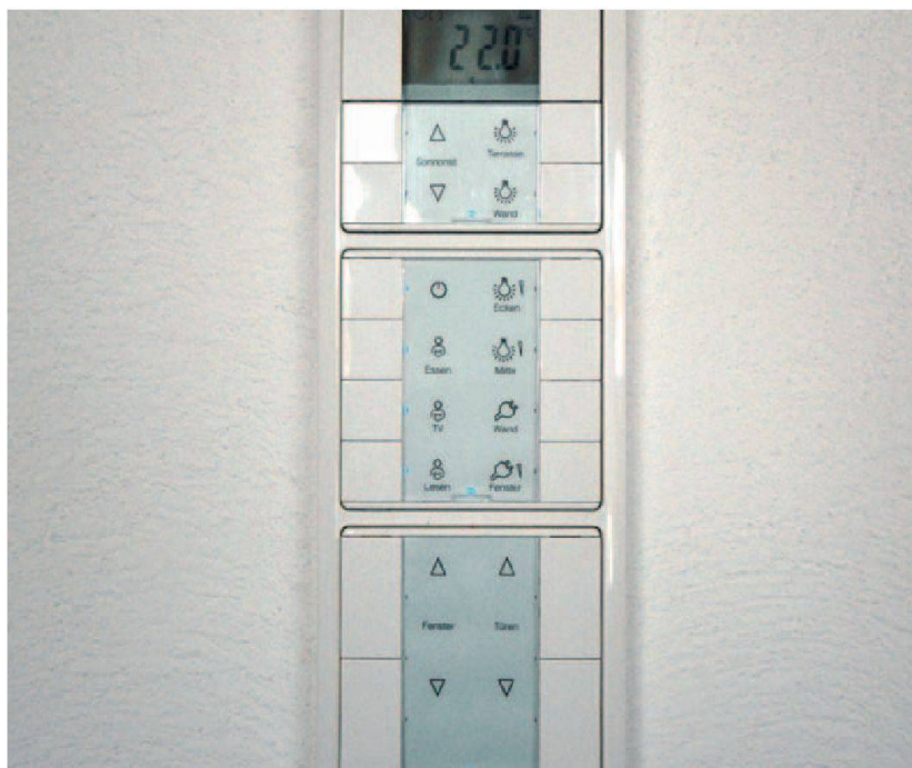
Vue d'un ensemble thermostat et interrupteurs installé. © DOMO-Energie
