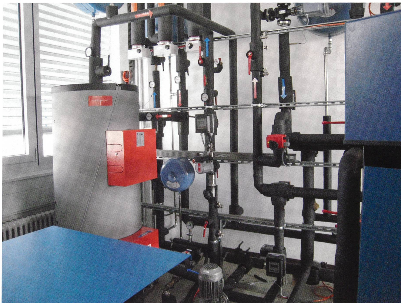
Infrastructure thermohydraulique pour tester la capacité d'adsorption d'unités de pompes à chaleur d'une capacité de refroidissement allant jusqu'à 10 kW. Une capacité de chauffage de 30 kW sera testée dans le cadre du projet THRIVE. © HEIG-VD
