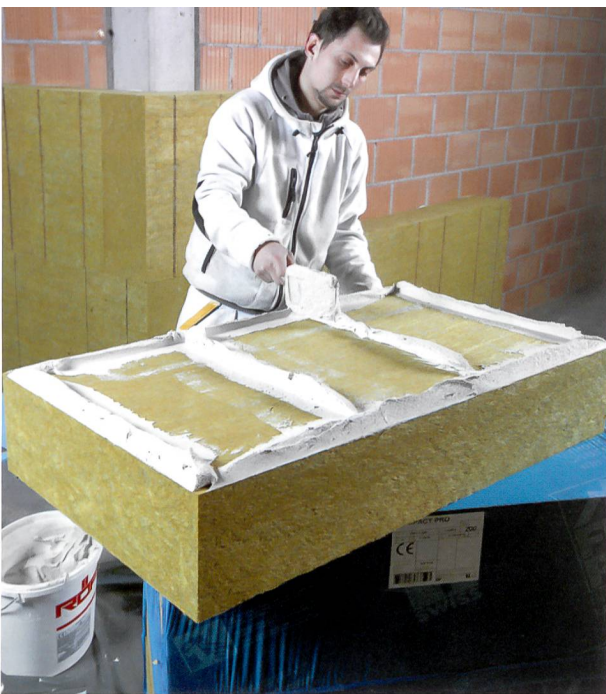
Préparation de la surface du panneau avec de la colle spéciale. © Flumroc
