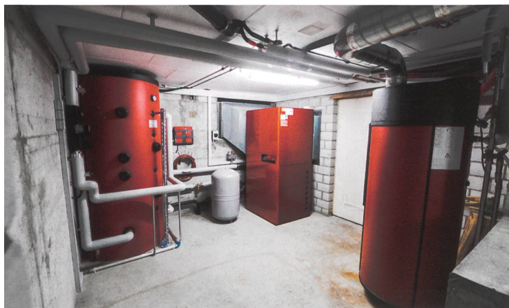
Les nouvelles installations de chauffage qui remplacent les anciennes au mazout peuvent être en partie financées par le Programme Bâtiments. DR/© Fluxif (Gerry Nitsch) – Programme bâtiments
