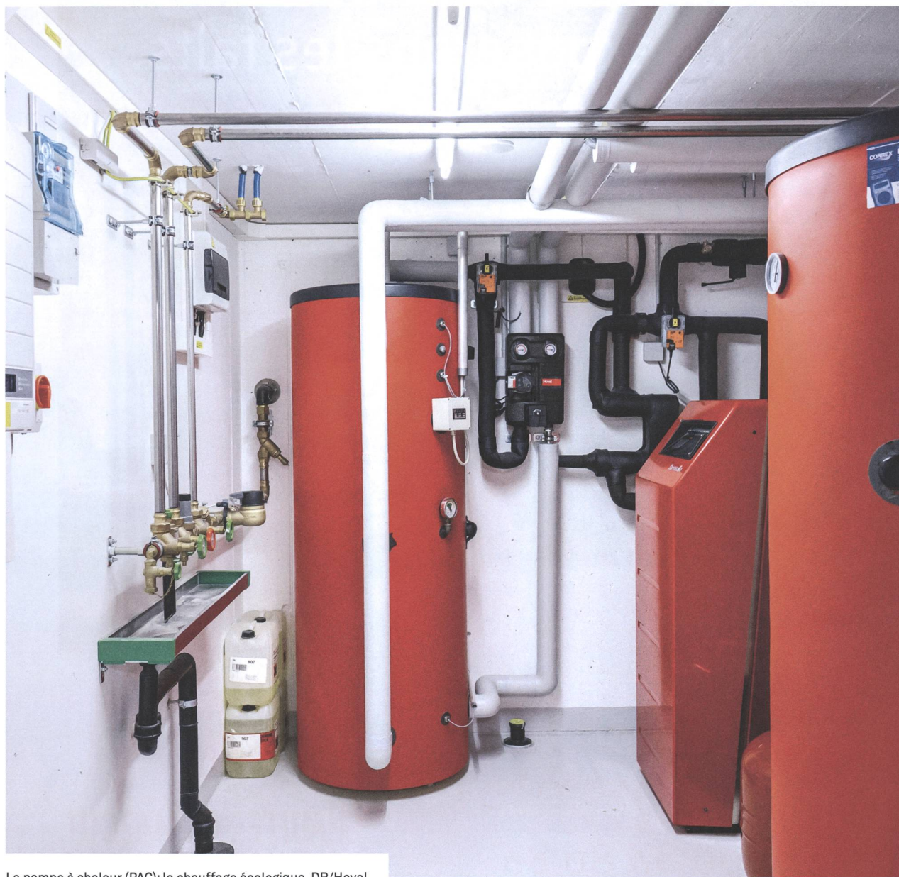
La pompe à chaleur (PAC): le chauffage écologique. DR/Hoval
