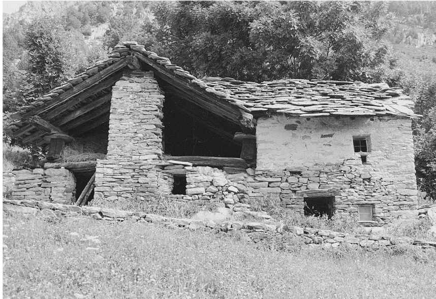
Ill. 2: Echallogne. À gauche, dépendance céréalière pour le séchage des javelles. Observer les supports récupérés d'un «raccard» préexistant.
