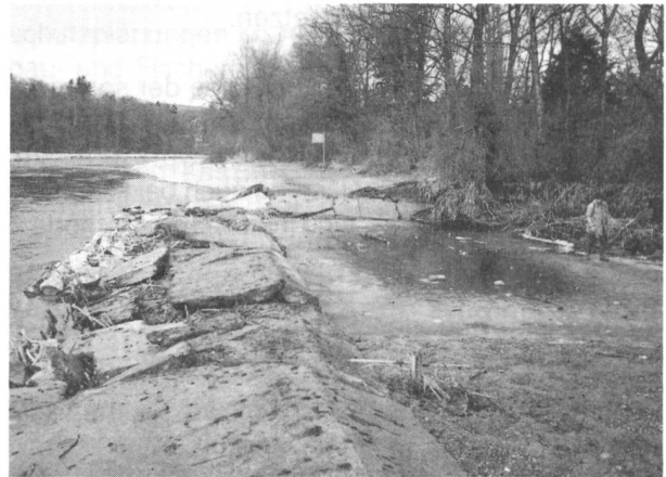
Streichwehrbecken oberhalb der Gürbeeinmündung am zerfallen (Bild: RPA)
