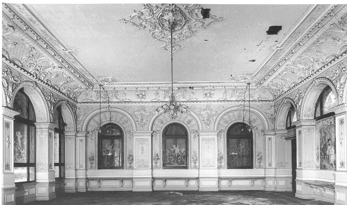
Interlaken, Speisesaalbau des Grandhotels Schweizerhof von 1896/97. Nach dem Hotelbrand 1971 vernachlässigt, erlitt der bedeutendste Neurokokosaal des Kantons Bern Totalschaden durch den Hausschwamm. Der Internierschutz des Denkmalpflegegesetzes kam 30 Jahre zu spät. (Foto: Denkmalpflege des Kantons Bern, Gerhard Howald)
