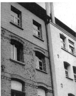
Alter und neuer Sichtbackstein von 1898 und 1992 beim Unitobler
