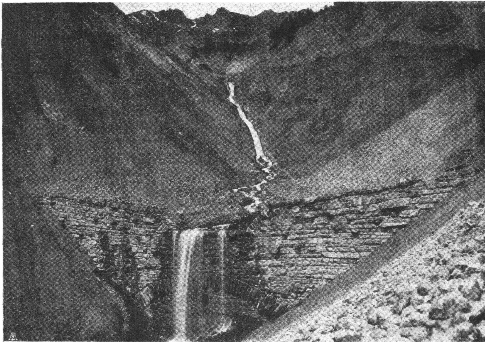
Abb. 4. Lamm- bach bei Brienz. Sperre V und Schale. Fig. 4. Correction du Lamm- bach, près Brienz. Barrage V et bassin.
