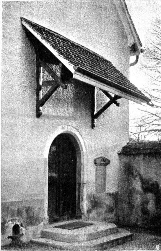
Abb. 7. Eingang der St. Annakapelle in Oberkirch. Ziegelklebdach über der Türe. — Fig. 7. L'entrée de la chapelle Ste-Anne, à Oberkirch, et son avant-toit protecteur recouvert de tuiles. Bon exemple.
