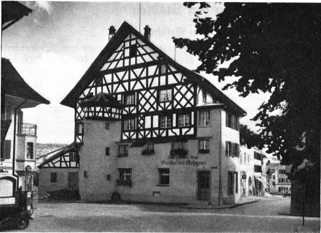
Die Freilegung des Fachwerks am alten Gasthof zum goldenen Kopf in Bülach.
