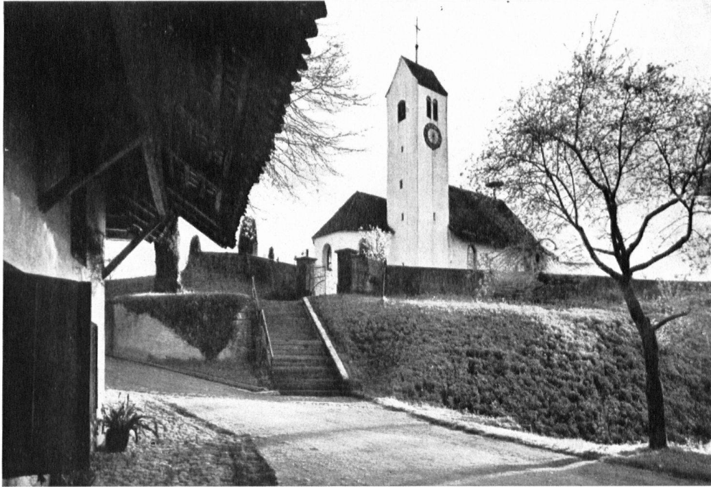
Die vom Abbruch bedrohte spätgotische Kirche im aargauischen Dorfe Möriken bei Wildegg. L'église gothique de Möriken, proche du château de Wildegg, sera-t-elle détruite?
