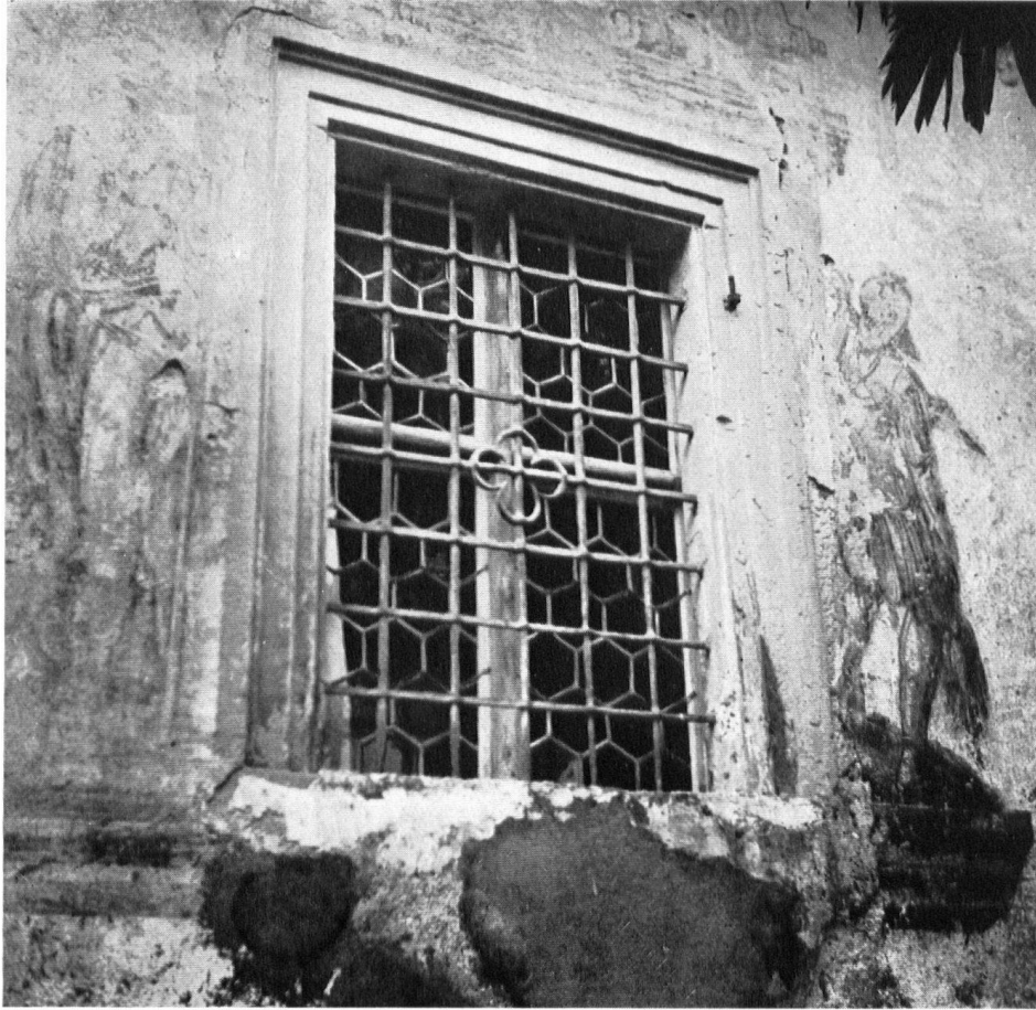
Innerschweiz. Zerfallende Fresken an einem ehemaligen Schwyzer Herrenhaus. Les peintures décoratives d'une antique maison patricienne, à Schwyz. Freschi deteriorati in una vecchia casa padronale svizzera.
