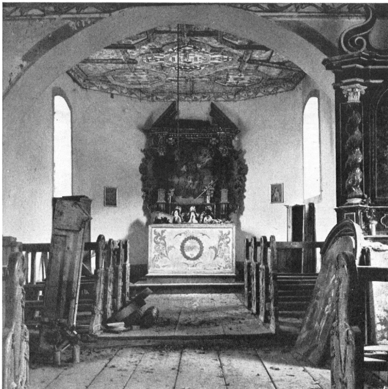
Das schöne Innere schien dem rettungslosen Zerfall entgegen zu gehen, durch die reichgemalte Decke trüffelte das Regenwasser, und die faulenden Bretter drohten herunterzustürzen.
