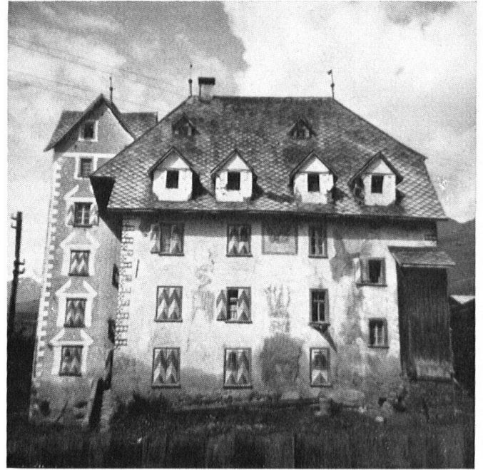
Château construit en 1666 par la Famille de Mont-Schauenstein à Vella, Lumnezia. Il occupe la place d'honneur dans le village. Mais il a grand besoin de restauration. Il fait penser à l'adage du P. Notker Curti: «Wenn ein Bauer ein Herrenhaus übernimmt, macht er es kaputt, oder es macht ihn kaputt.» Les boiseries sont déposées au Musée National à Zurich.
