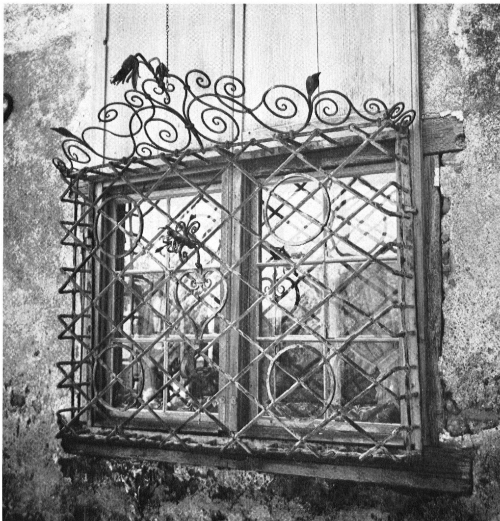
Ritterhaus in Bilten: reiches, handgeschmiedetes Fenstergitter. Das um- gebende Mauerwerk zeigt, wie verdienstvoll eine Erneuerung wäre.
