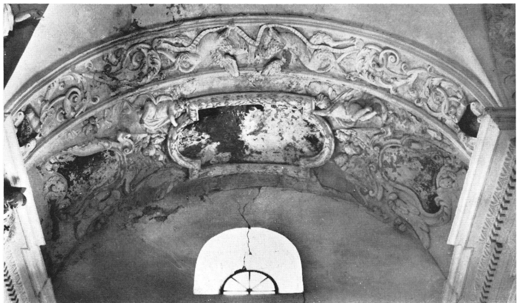
Etat déplorable de la voûte au-dessus de l'autel de St-Sébastien avant la restauration
