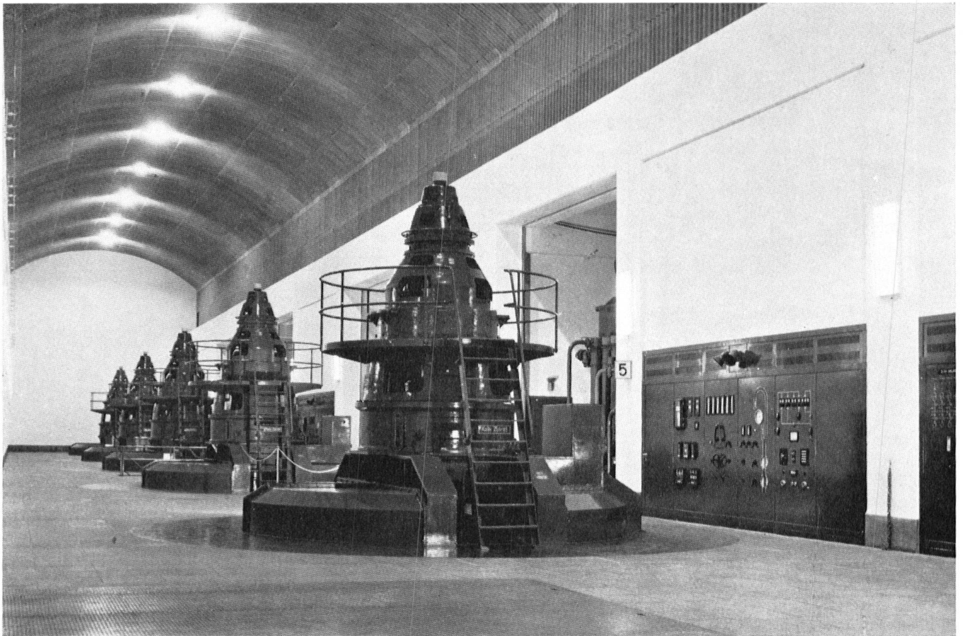
Un bon nombre de centrales, pendant et après la guerre, ont été logées en de spacieuses cavernes. Ici, celle d'Innertkirchen dans l'Oberhasli BE.
