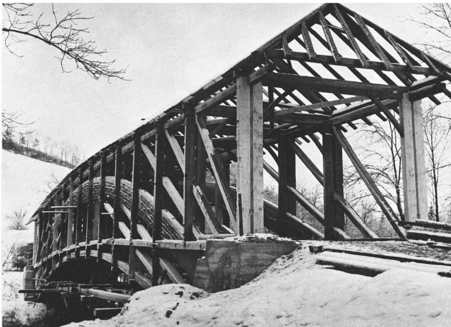
Neuaufstellung der Bogen-Holzbrücke Hasle-Rüegsau in Wintersei 1957/58. Die 1839 erbaute Brücke überspannt die Emme in einer Weite von rund 60 m.
