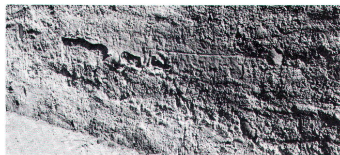
Malgré un décollement partiel dû à un ruissellement, ce crépi à la chaux traditionnel a bien résisté (photo Baertschi).
