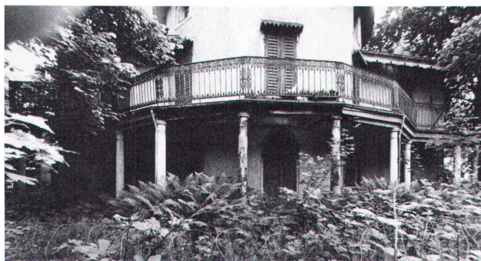
Wo ein Gebäude dem Zerfall preisgegeben wird, ist es kaum mehr zu retten (Bild Stähli)
