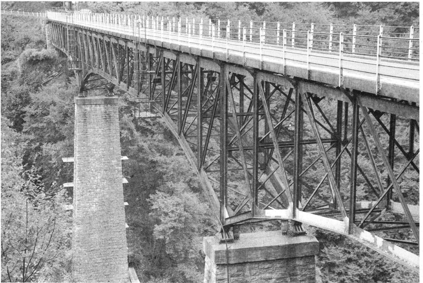
«To be or not to be» ist die Frage für eine der ältesten Eisenbrücken der Schweiz. Der Staatsrat des Kt. Tessin scheint selbst nicht zu wissen, was er (bezahlen) will. Die Brücke spannt sich über eine romantische Schlucht oberhalb Chiasso.
