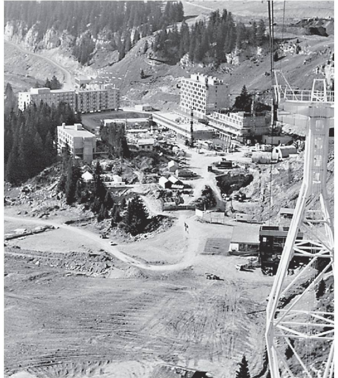
Blick auf die Baustelle des Wintersportortes Flaine in Hochsavoyen, (1969) (Bild Archives G. Chervaz)
