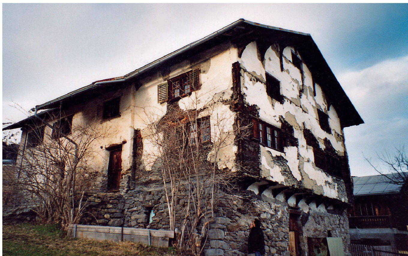
Das Gebäude in Vella (GR), dessen Grundmauern auf das 15. Jahrhundert zurückgehen, zeigte sich 2003 schon vor dem illegalen Abbruch verlottert.
