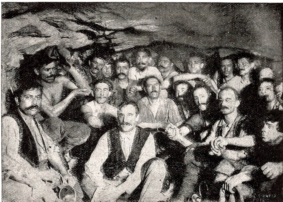
Die letzte Schicht des nördlichen Vortriebs im Bötschbergtunnel, welche dazu bestimmt war, den Schutt abzuräumen und die beiden Geleise zu verbinden.
