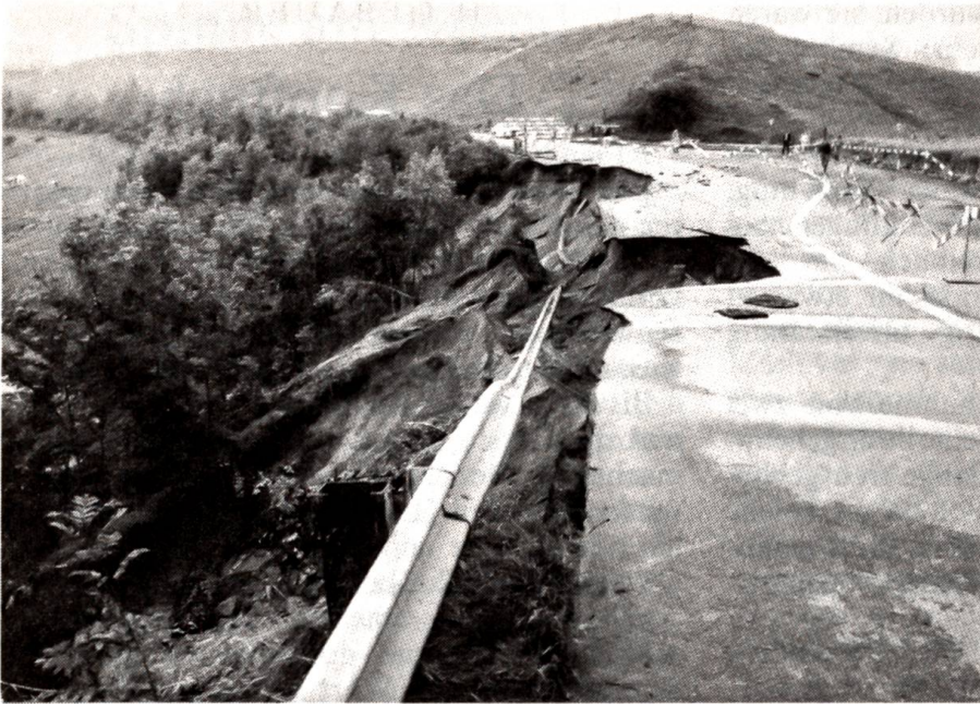
Unwetterschäden im Juli 1977 in der Region Bern
