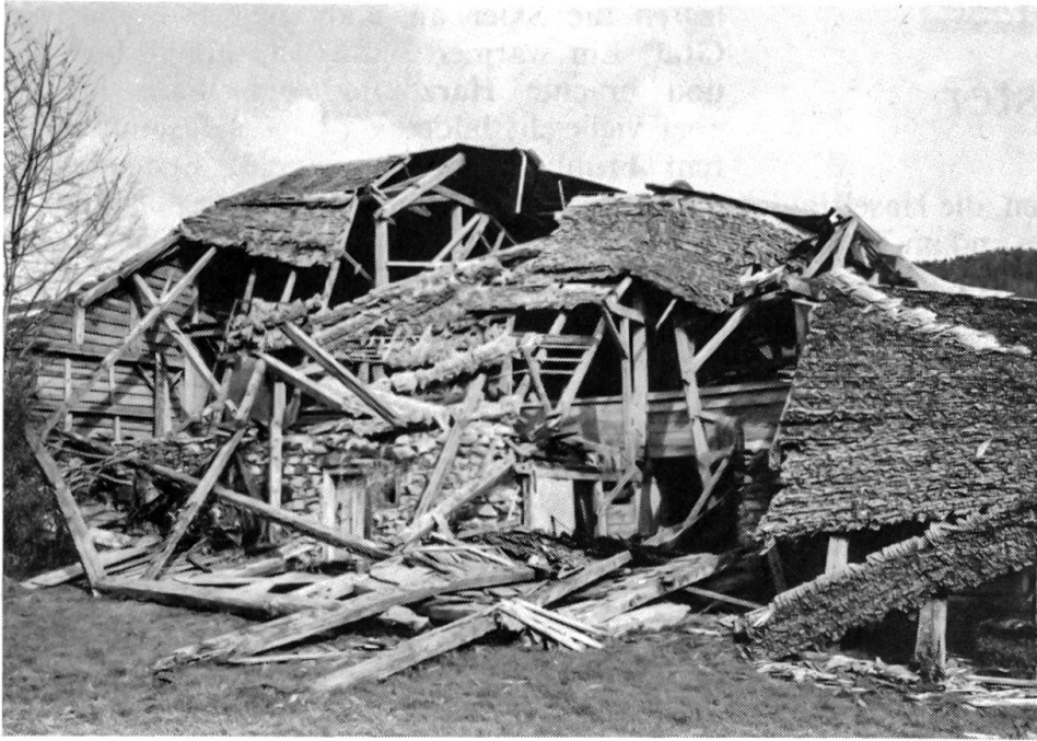
Schaden durch Schneedruck
