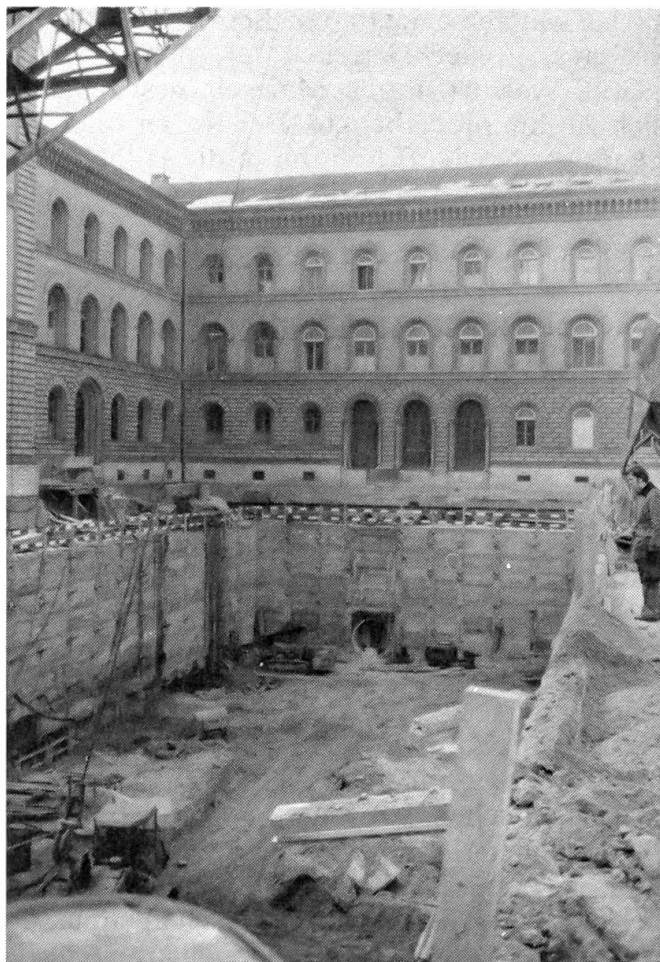
Personenschutzräume für das Bundespersonal Im Hofe des Bundeshauses-West dient diese mächtige Baugrube der Erstellung von vorgeschriebenen Schutzräumen.
