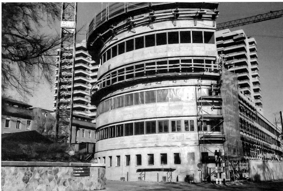
Imposanter Neubau für das Berner Inselspital In diesem neuen Polikliniktrakt sollen ab 1994 die Kliniken für Allergien, Hals-, Nasen- und Ohrenleiden, Orthopädie und Rheumatologie untergebracht werden. (Foto: Fritz Lörtscher, Bern)
