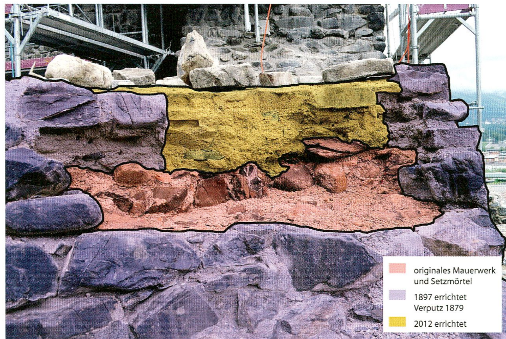
Abb. 9: Turm, Mauer M3, Blick gegen Nordosten. Frei- gelegtes Originalmauer- werk sowie Mauerwerk der Restaurierungen 1897 und 2012 (Foto AAM).
