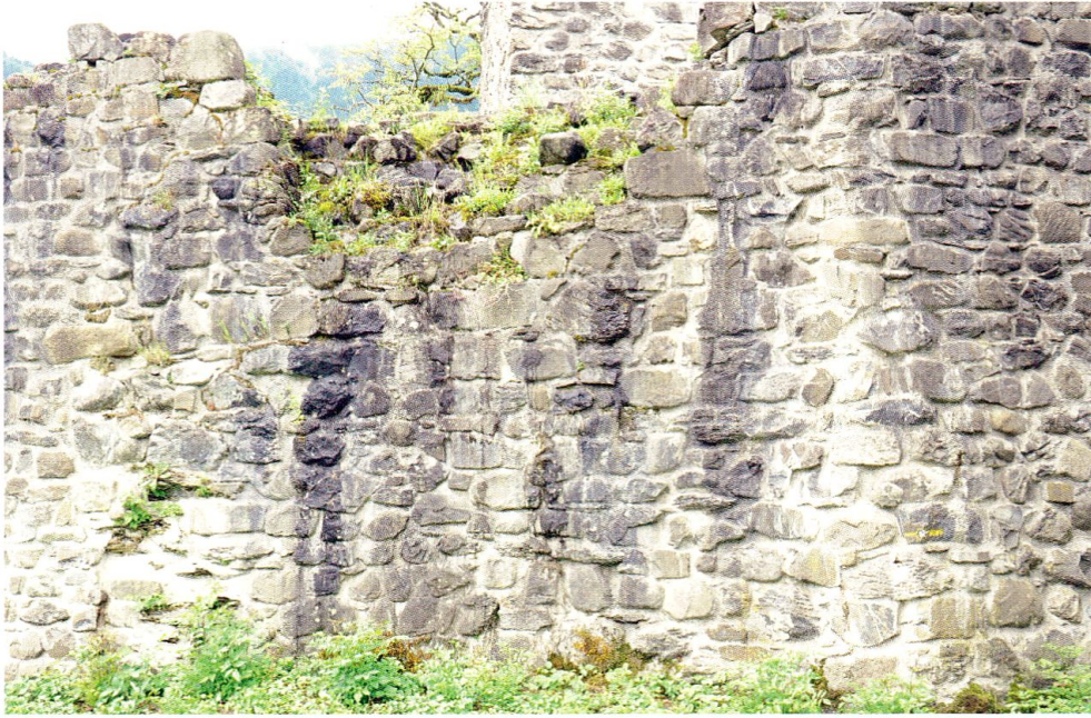
Abb. 6: Umfassungsmauer, Mauer M7, Blick gegen Südwesten. Rinnsal an stark durchnässtem Mauerwerk (Foto AAM).
