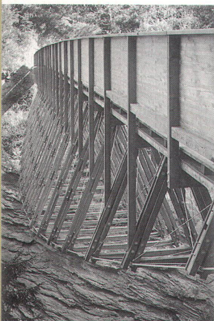
Weit gespreizte Untergurtseile aus Stahl und Druckgurte aus Holz halten die Traversina Brücke stabil
