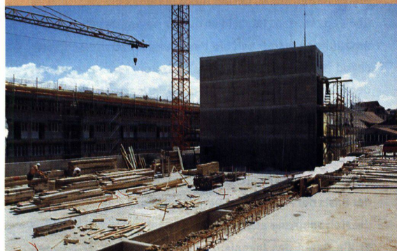
Das Betonfundament der zweiten Zeile mit dem Treppenhaus, ebenfalls aus Beton. Im Hintergrund die schon aufgerichtete erste Zeile
